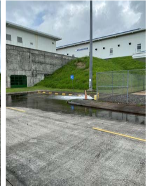
Purga de hidrante en PTAR
