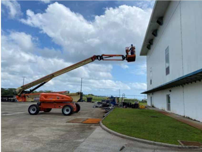
Trabajo en alturas en el edificio de mantenimiento, personal con EPP visible
