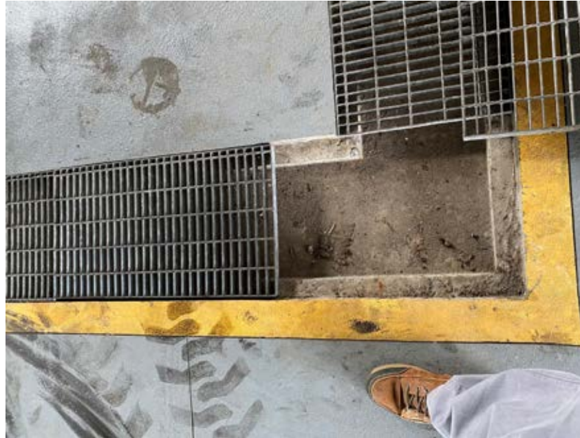
Estado de drenajes al separador agua/aceite
