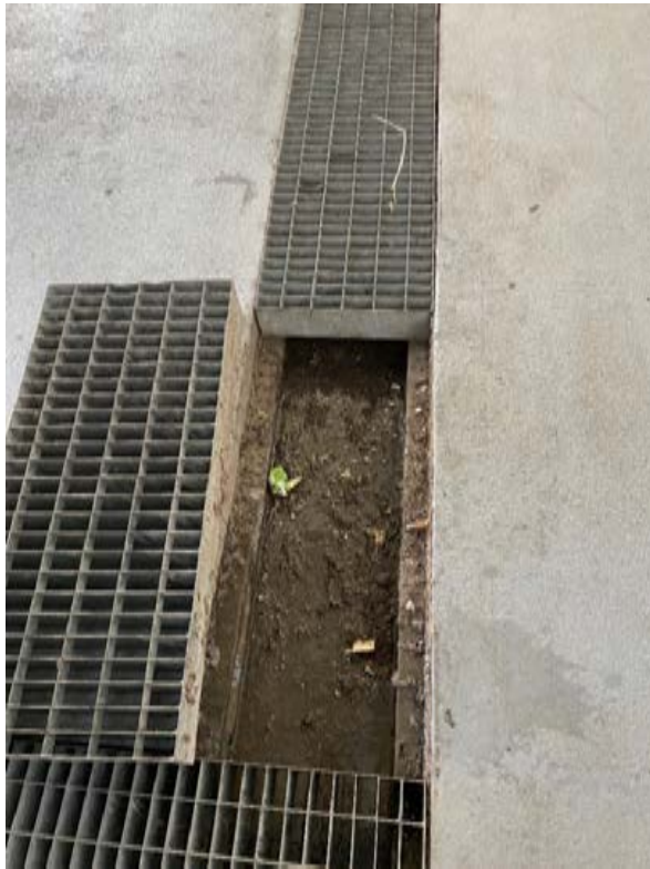
Estado de limpieza de drenajes para el separador agua/aceite
